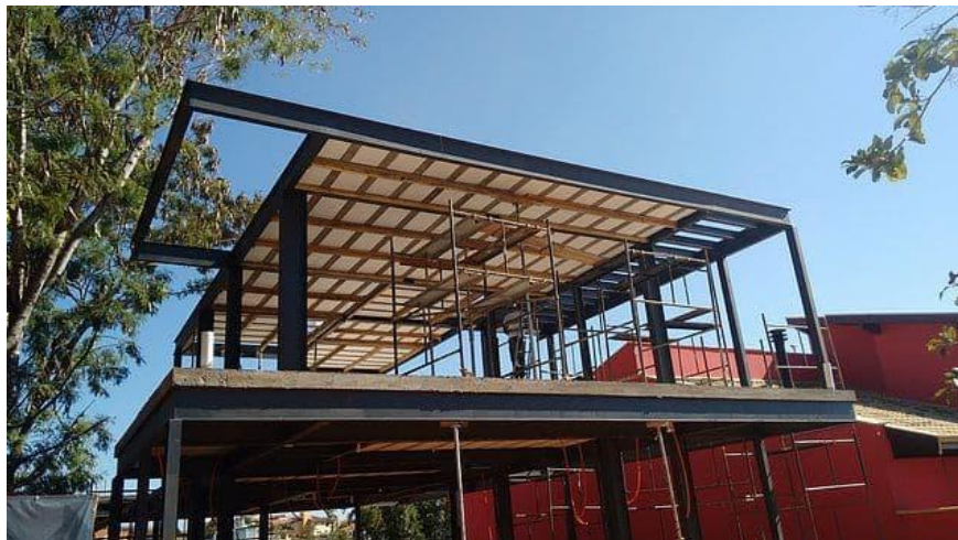
Figura 1 – Estrutura metálica de um espaço residencial.
