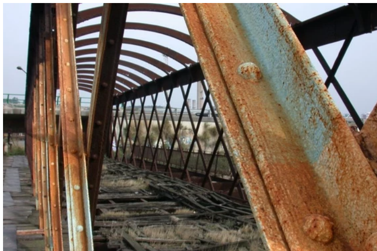
Figura 4 - Corrosão de estrutura metálica provocada pela oxidação. Ação atmosférica.
