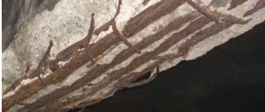
Figura 2 - Processo de oxidação de estrutura metálica. Corrosão generalizada.
